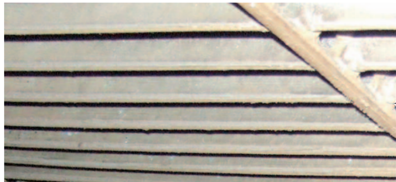
Kühlturm nach der Umstellung auf FINEAMIN®
